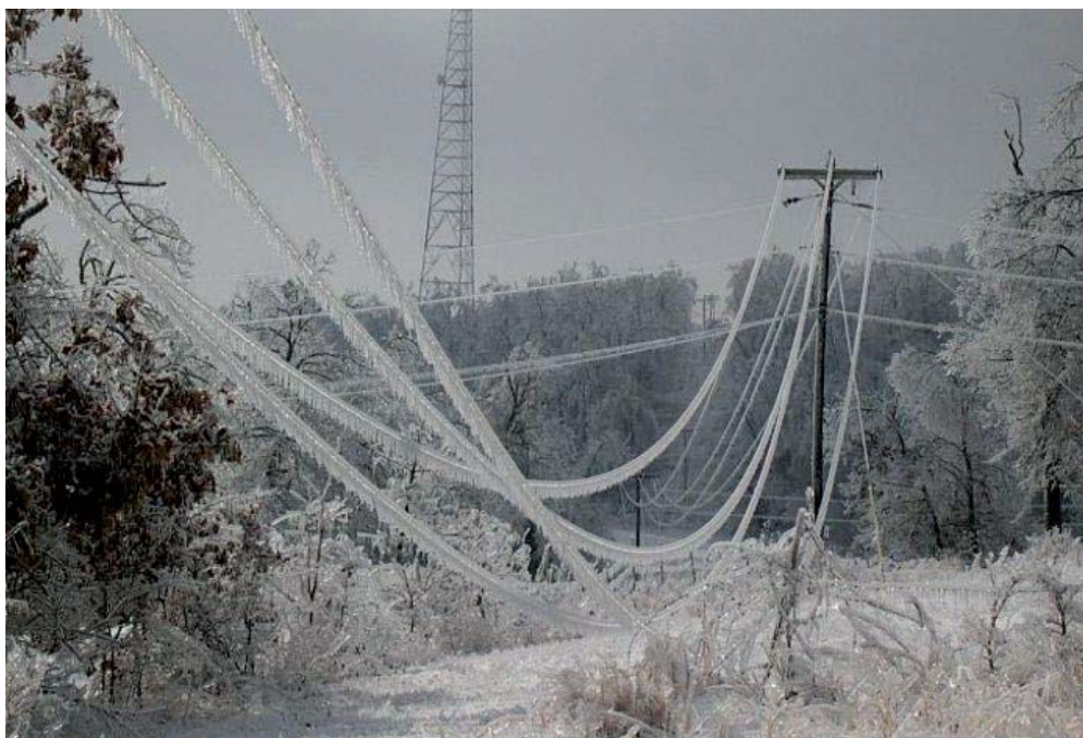
Zaleđen provodnik na nadzemnom vodu 0,4 kV
